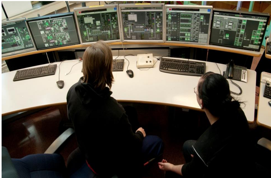
Bild 2 Kontrollrum i Distaloyverk med datoriserade styrsystem
